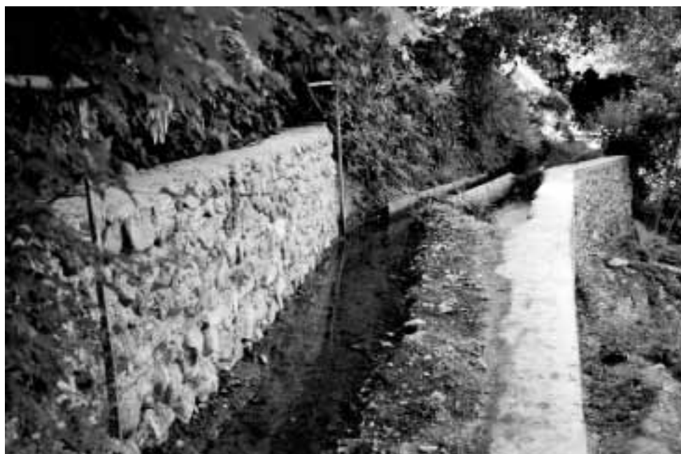
Stützmauer für Bewässerungskanal, der durch Erdbeben zerstört wurde.
